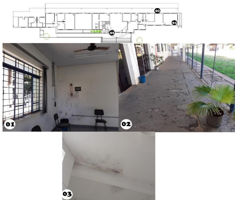
Figura 15. Patologias no Interior e Exterior da Estação
