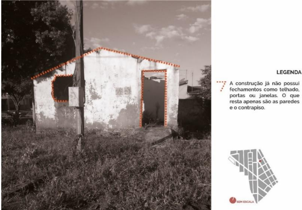
Figura 07. Construções abandonadas no Jardim Esplanada.
