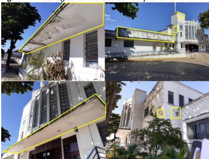
Figura 14. Patologias na Fachada da Estação Ferroviária
